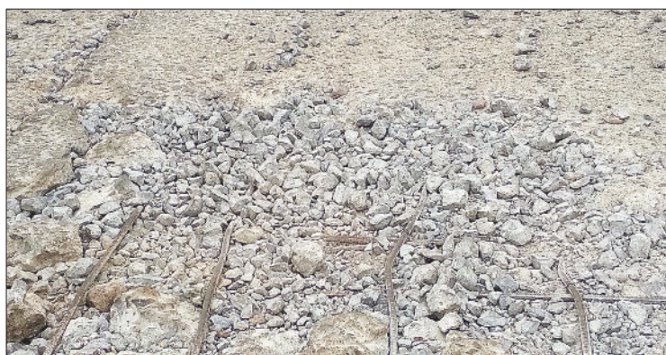
कुकदा-रिंगनी की जर्जर सड़क।
